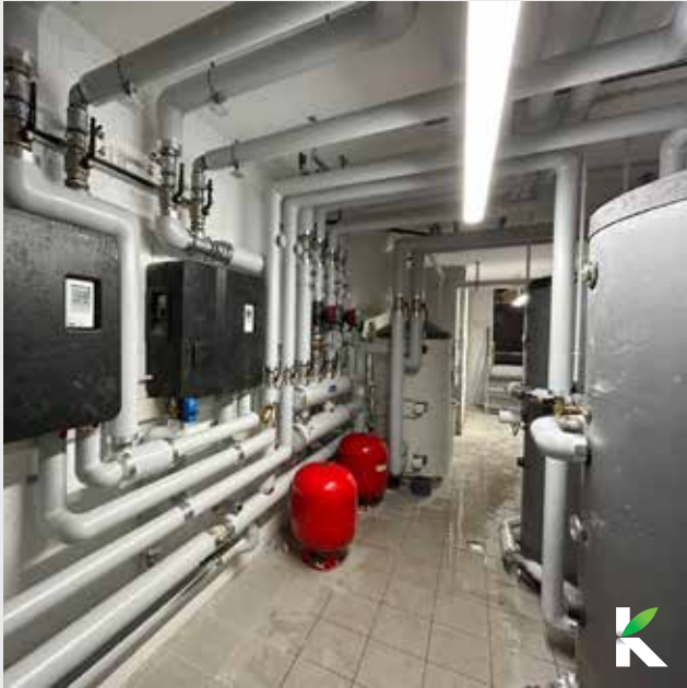
RESIDENZA DEGLI ULIVI Realizzazione impianto idrico sanitario e di climatizzazione a servizio della residenza degli Ulivi a Riva del Garda (TN) (committente - Pamigi S.r.l.).
